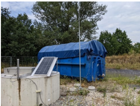
Brunnen mit installierter Technik
