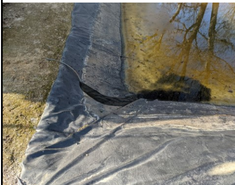
Umgehung des Filtercontainers bei Frost
