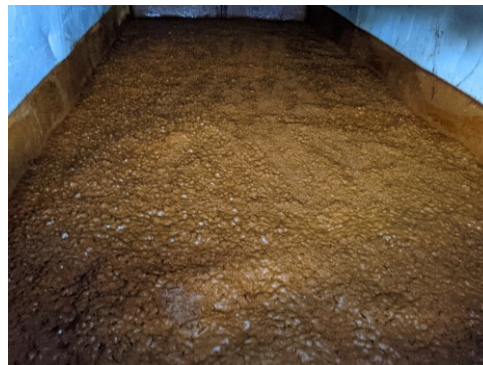
Eisenablagerung auf dem Kiesfilter vor dem Einbau des Strohs
