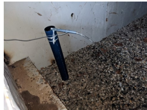
Zulauf in den Filtercontainer
